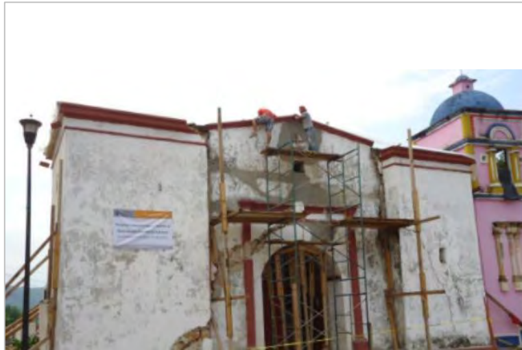
FOTOGRAFÍA 53: Especialistas del INAH rescatan los inmuebles religiosos de Oaxaca, que registraron daños tras los sismos del 20 de marzo y el 2 de abril.
