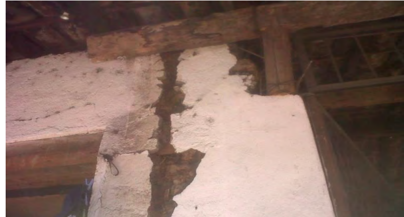
FOTOGRAFÍA 13: desplome en muro, fachada calle Benito Juárez (QUIÑONES MONTES DE OCA, 2013)
