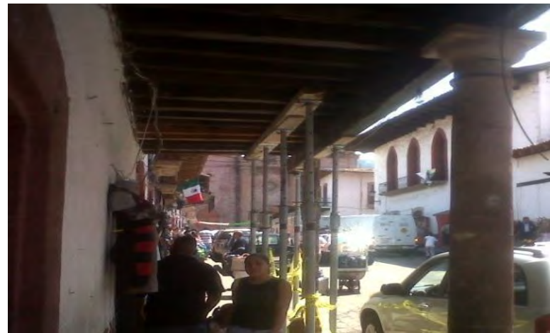
FOTOGRAFÍA 19: Apuntalamiento por posible derrumbe de balcón (QUIÑONES MONTES DE OCA, 2013)
