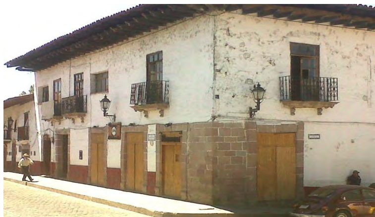
FOTOGRAFÍA 27: Balcones vencidos e inestables perspectiva esquina Bocanegra y Porfirio Díaz (QUIÑONES MONTES DE OCA, 2013)
