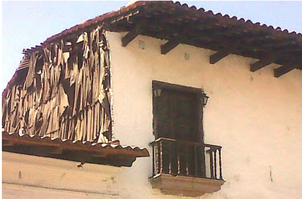
FOTOGRAFÍA 2: Pérdida de muro colindante de lado izquierdo, sobre la calle Joaquín Arcadio Pagaza
