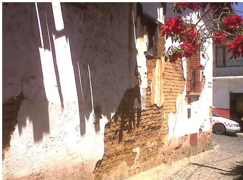
FOTOGRAFÍA 1: Deterioro en fachada por desplome, perspectiva de la esquina calle San José (QUIÑONES MONTES DE OCA L. A., 2013)
