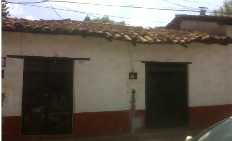
FOTOGRAFÍA 9: Fisuras en fachada perspectiva calle Monte Alegre. (QUIÑONES MONTES DE OCA, 2013)
