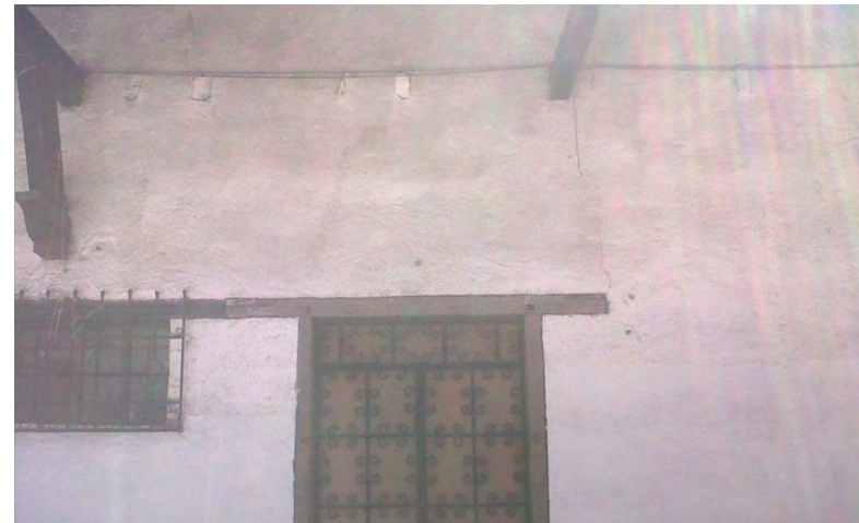
FOTOGRAFÍA 22: Fisuras en fachada, calle Nicolás Bravo (QUIÑONES MONTES DE OCA, 2013)
