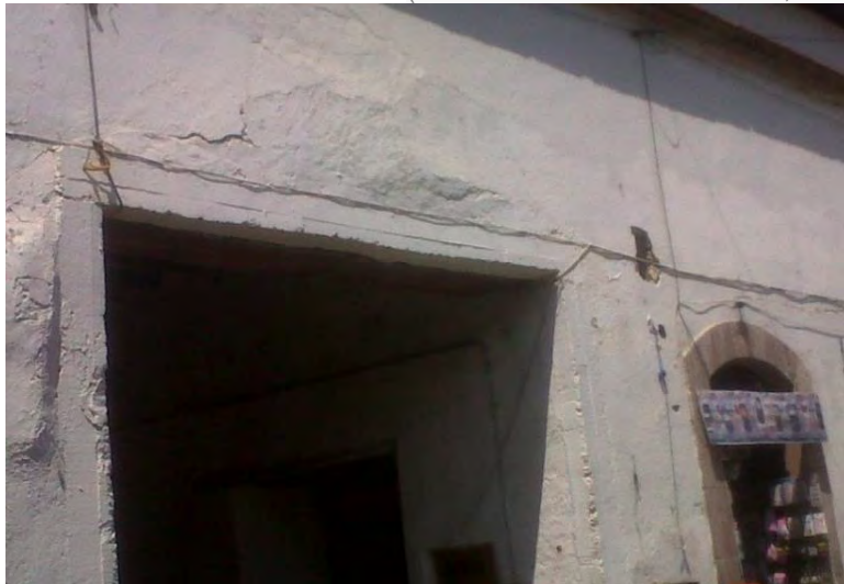
FOTOGRAFÍA 16: Falla en Trabe de carga. Calle Benito Juárez (QUIÑONES MONTES DE OCA, 2013)
