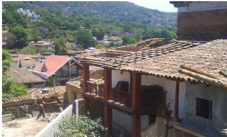
FOTOGRAFÍA 99: Vista en de la casa, con cubierta deteriorada (QUIÑONES MONTES DE OCA (2014))
