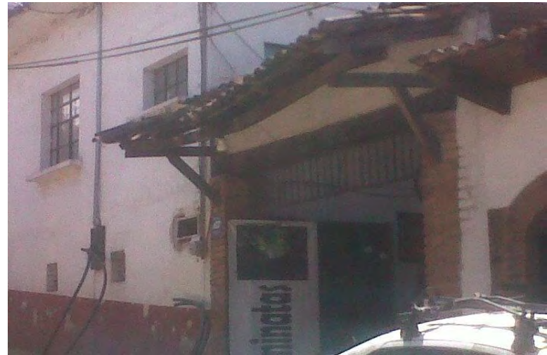
FOTOGRAFÍA 10: Vencimiento de cubierta, calle Zaragoza (QUIÑONES MONTES DE OCA, 2013)
