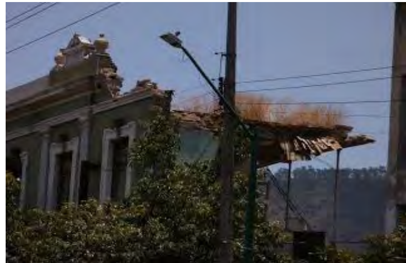
FOTOGRAFÍA 57: Casa habitación deteriorada y solo queda la fachada. (Bianconi, 2006 )
