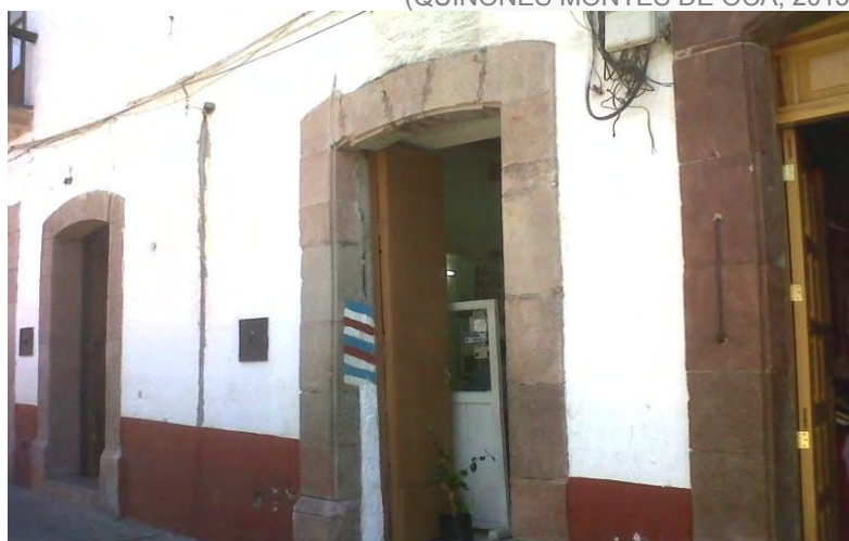
FOTOGRAFÍA 28: Marcos de accesos en piedra, vencidos. Calle Bocanegra (QUIÑONES MONTES DE OCA, 2013)
