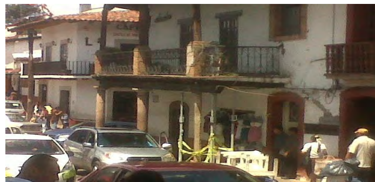
FOTOGRAFÍA 18: Falla estructural (balcón) calle 16 de septiembre
