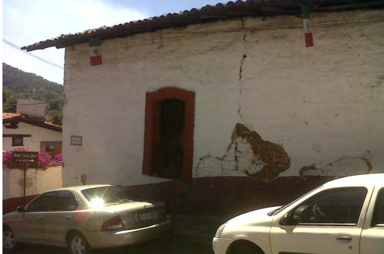
FOTOGRAFÍA 8 Fisuras en fachada perspectiva calle San Vicente (QUIÑONES MONTES DE OCA, 2013)
